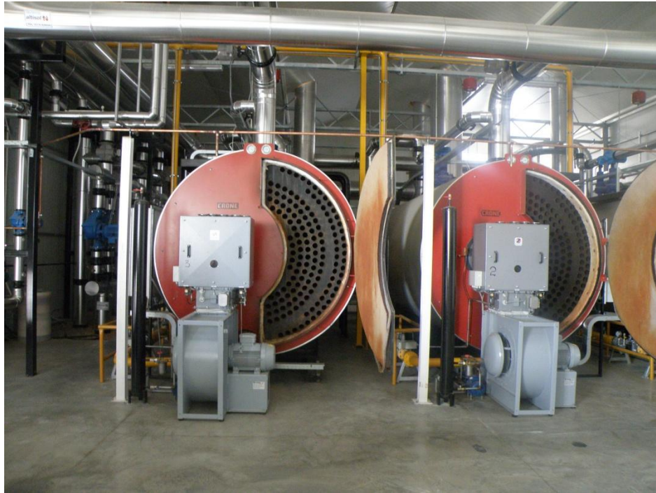
Σύστημα κεντρικής θέρμανσης με λέβητα θερμού νερού
